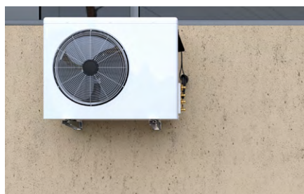
Condizionatori a parete.
